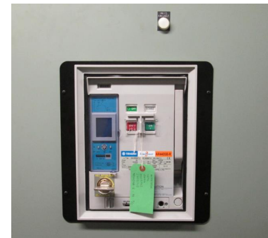
Po: Modernizacja ACB, przekaznik ochrony z LCD
